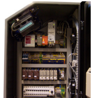
Aufbau vom Schaltschrank
